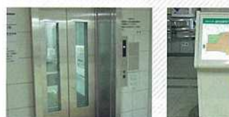
改札フロアとホームを結ぶエレベーター
