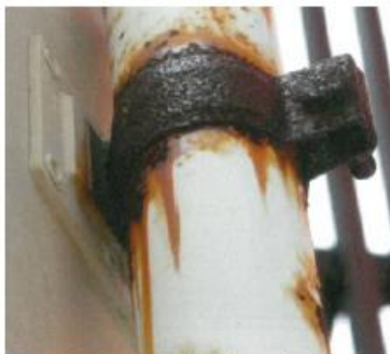
腐食（判定Ⅲ）
