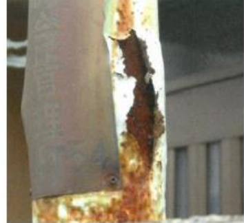
腐食（判定Ⅱ）
