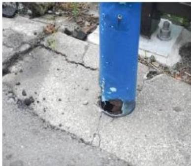
腐食による穴（判定Ⅲ）
