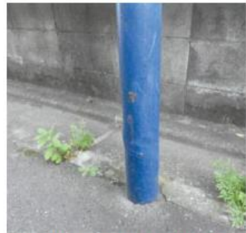
腐食による変形（判定Ⅲ）
