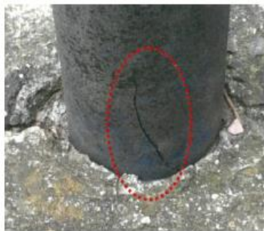
亀裂（判定Ⅱ）
