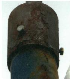
腐食（判定Ⅲ）
