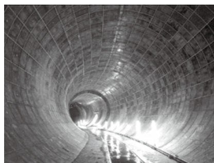
▲内径8.5mの貯留管
