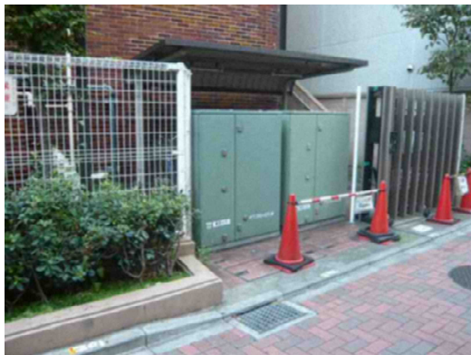
【公共用地への地上機器設置事例】
