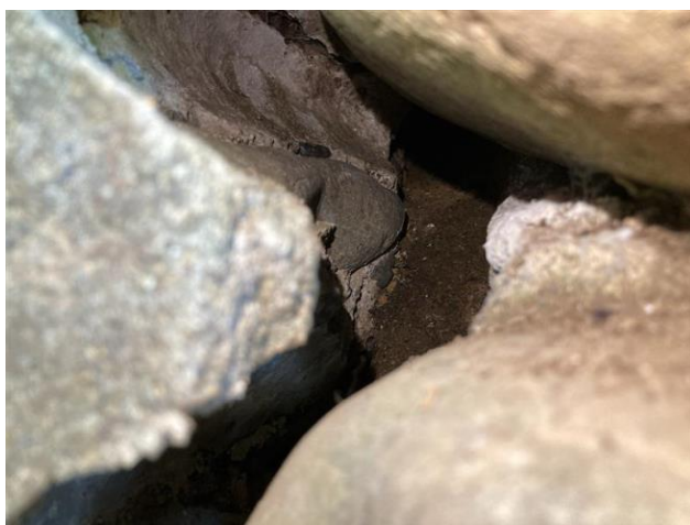
写真8 石積み亀裂内部
