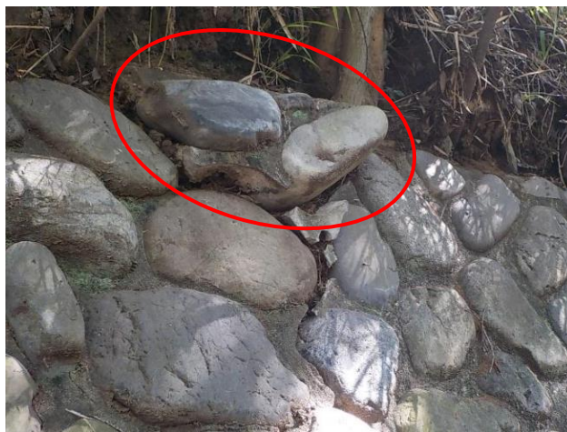
写真7 石積のせり出し状況
