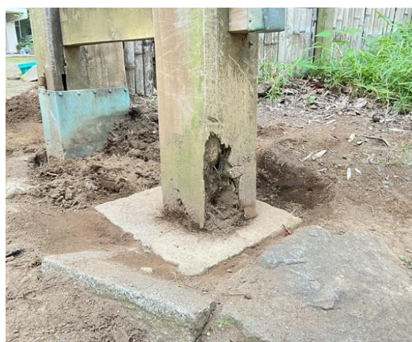
写真 2 控柱の腐朽状況
