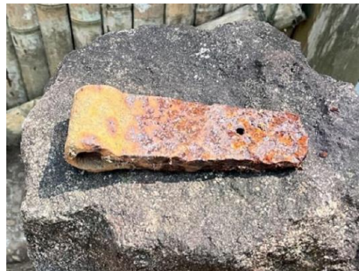
写真5 肘壺金物の破損状況
