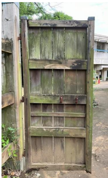
写真3 大扉の劣化状況
