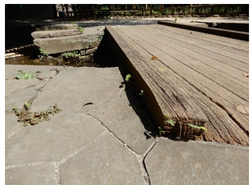
写真 4-24 : 縁部の摩耗 (2022. 07. 08 撮影)
