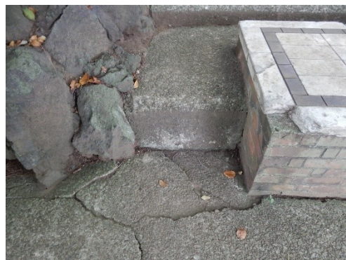
写真 4-18 : 台座コンクリートの破損 (2022. 07. 08 撮影)
