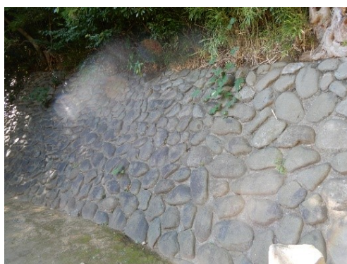
写真 4-100 : 石積目地の破損 (2022. 07. 08 撮影)
