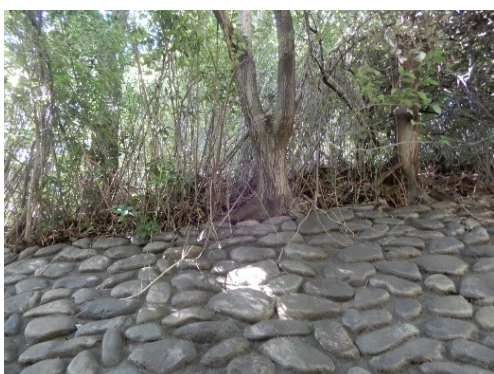
写真 4-99 : 石積上の破損 (2022. 07. 08 撮影)
