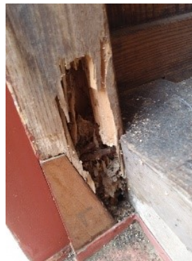
写真 4-15：シロアリの被害 (2022. 07 撮影)
