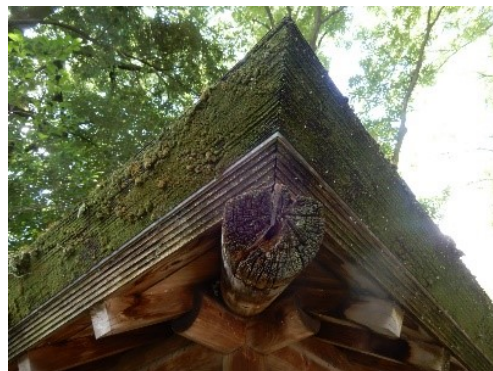
写真 4-26 : 屋根材の腐朽 (2022. 07. 30 撮影)
