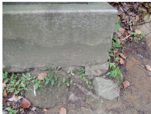
写真 4-49：基礎コンクリートの露出 (2022. 07. 08 撮影)
