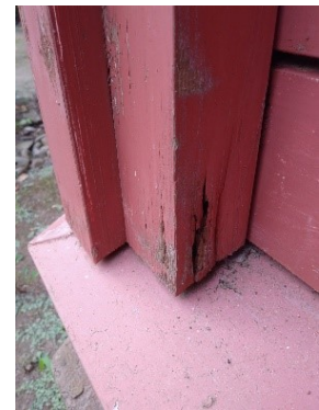
写真 4-16：建物外壁の劣化 (2022. 07 撮影)
