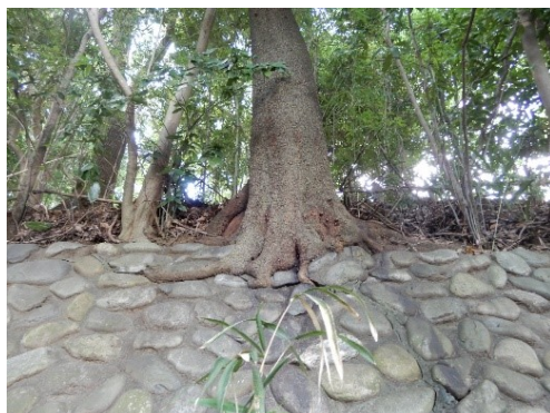
写真 4-96 : 石積上の破損 (2022. 07. 08 撮影)
