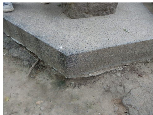
写真 4-42 : 浮き上がった基礎 (2022. 07. 08 撮影)
