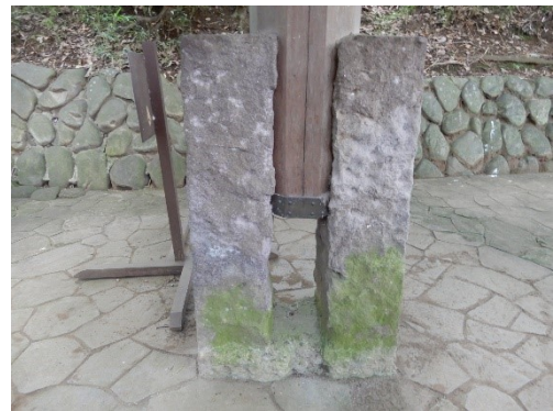
写真 4-29 : 基礎石のコケ (2022. 07. 030 撮影)
