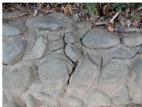
写真 4-97 : 石積目地の破損 (2022. 07. 08 撮影)
