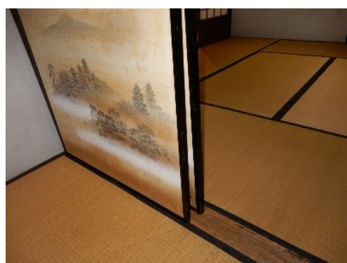
写真 4-9：襖の建具のゆがみ (2022. 07. 08 撮影)
