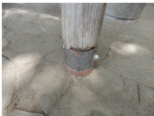
写真 4-27 : 柱脚の腐食 (2022. 07. 30 撮影)
