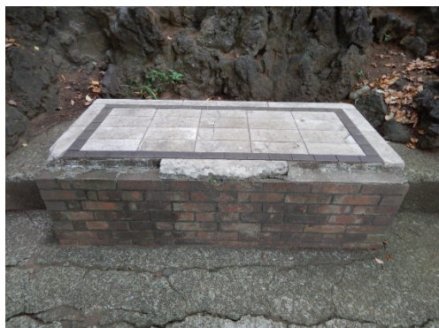
写真 4-17 : 台座の縁石の破損 (2022. 07. 08 撮影)
