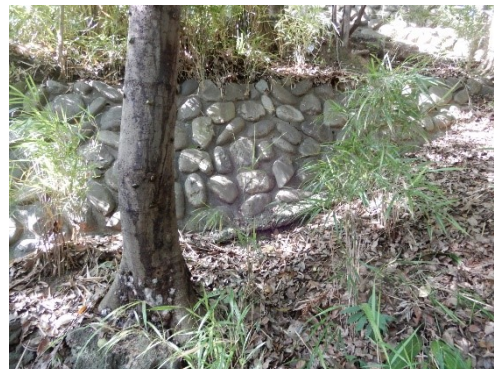
写真 4-72 : 心理崖の石積の破損 (2022. 07. 08 撮影)
