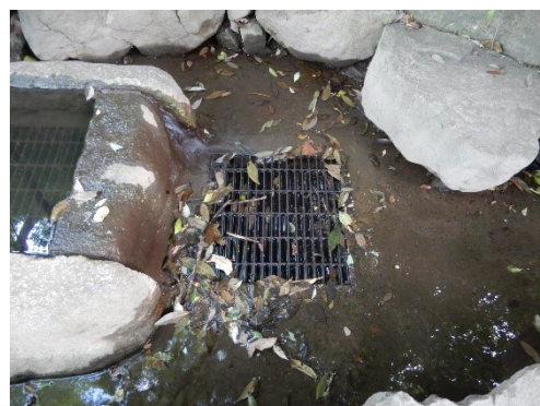
写真 4-74 : グレーチングの露出 (2022. 07. 30 撮影)
