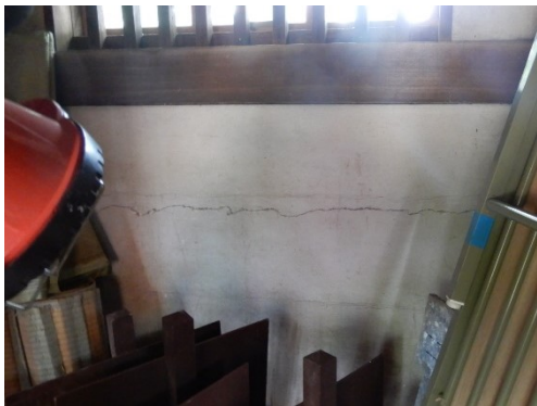
写真 4-14：内壁のクラック (2022. 07. 08 撮影)
