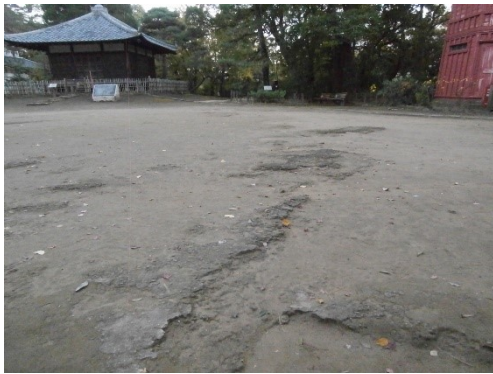
写真 4-81 : 時空岡の舗装面の劣化 (2022. 11. 27 撮影)
