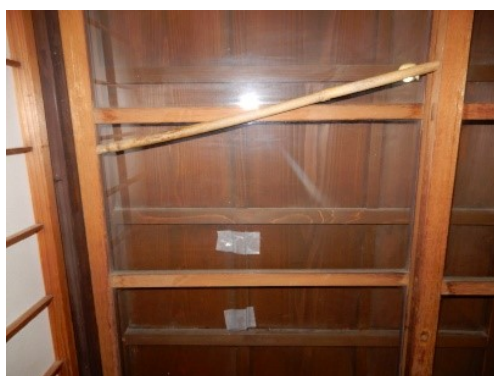
写真 4-10：雨戸の建具のゆがみ (2022. 07. 08 撮影)
