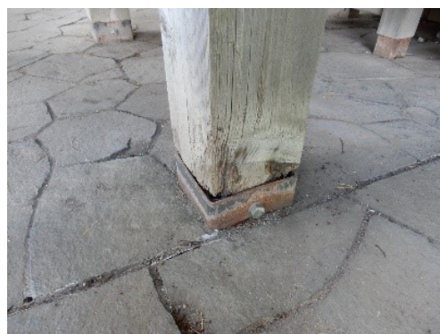
写真 4-20 : 柱脚の腐食 (2022. 07. 08 撮影)
