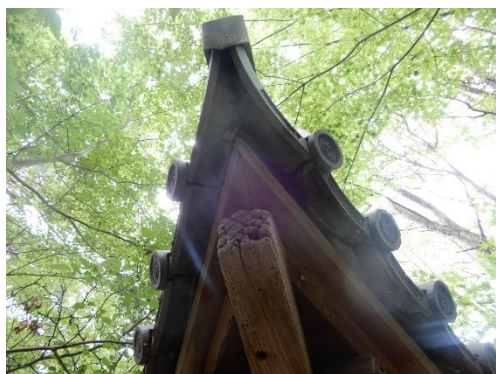
写真 4-41 : 軒桁の傷み (2022. 07. 08 撮影)
