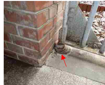
図 2-1-60 北面大扉 足元の金物がズレている
