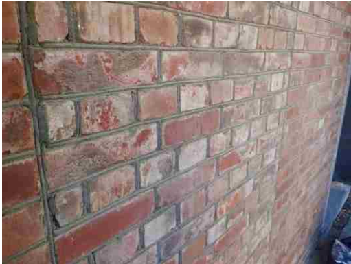
図 2-1-23 通路西面 煉瓦の風化
