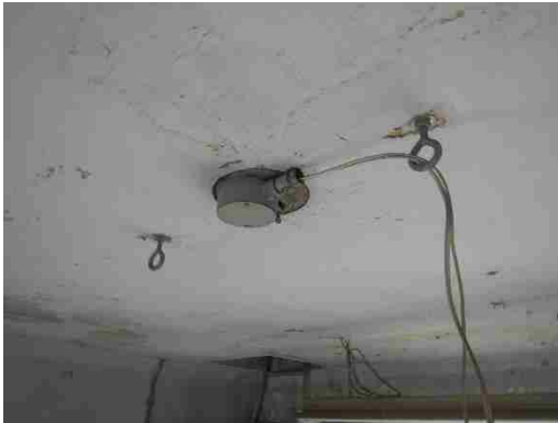
図 2-1-39 元守衛室天井 漆喰のひび割れ・塗装剥離
