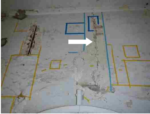
図 2-1-09 元守衛室東面のひび割れ アーチ開口上部にひび割れがみられる
