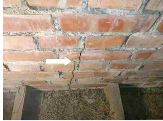
図 2-1-10 元守衛室東面のひび割れ(天井裏) 天井裏でもひび割れが確認された
