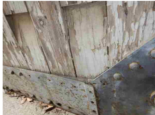
図 2-1-57 南面大扉 太鼓鉾の欠失 太鼓鉾がとれ、鉄板がはがれている
