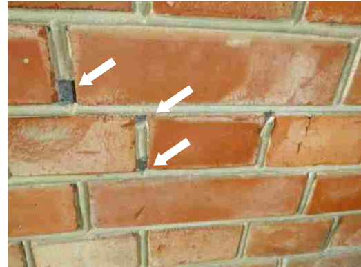
図 2-1-28 通路西面 覆輪目地の剥離
