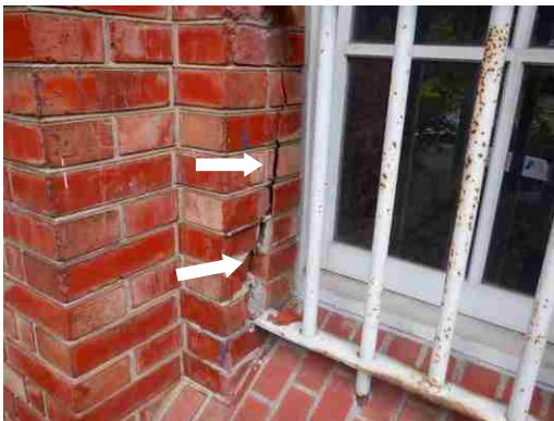
図 2-1-13 南面開口部 金物周りのひび割れ・破損
