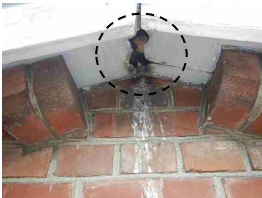
図 2-1-53 けらば側の厚板の軒裏の腐朽 屋根の頂部の軒裏に腐朽あり
