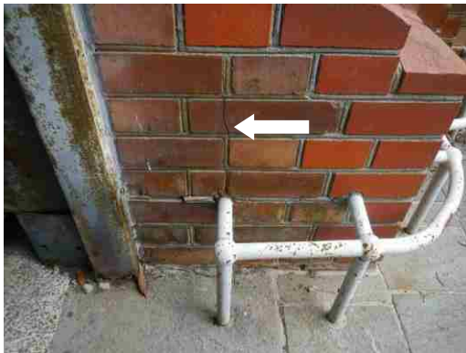
図 2-1-17 通路東面 金物周りのひび割れ 幅 1.3mm のひび割れが見られる
