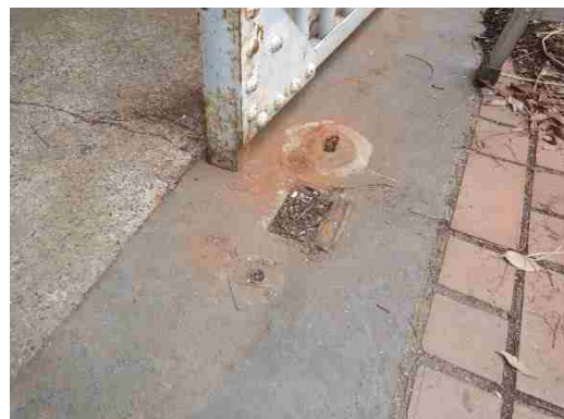
図 2-1-62 北面大扉の戸当たり金物 鉄の腐食が著しく、戸当たり金物が欠失している
