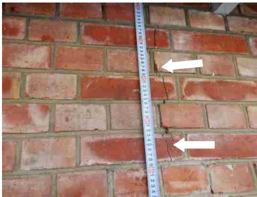
図 2-1-03 西面外部のひび割れ 幅 2.0mm 程度のひび割れが見られる
