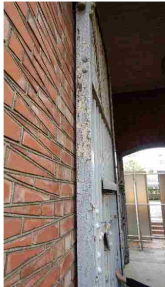
図 2-1-59 北面大扉 表面のペンキが剥落している
