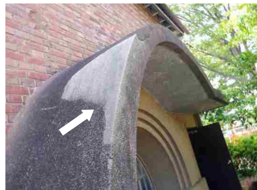
図 2-1-32 コンクリート庇のモルタル浮き 庇上面の補修跡部分に浮きが確認される
