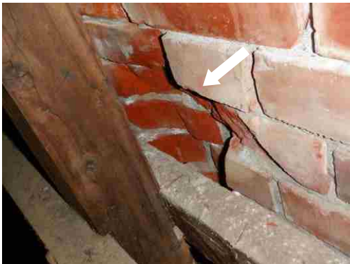
図 2-1-25 小屋裏北面 煉瓦の部分欠損
