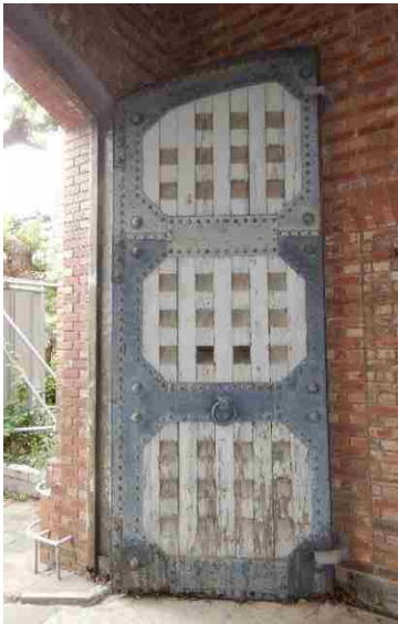
図 2-1-58 南面大扉 表面のペンキが剥落している
