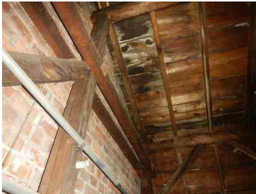
図 2-1-45 野地板の雨染み跡、白色変色
