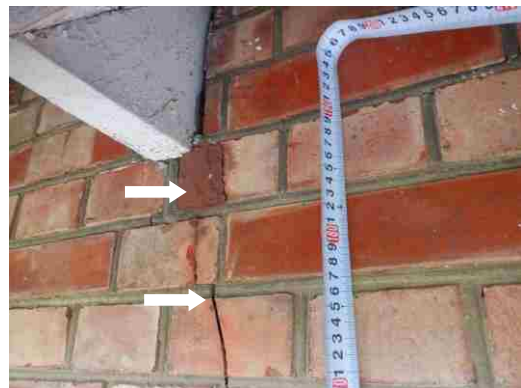
図 2-1-12 東面壁頂部のひび割れ 外部もひび割れが発生している
