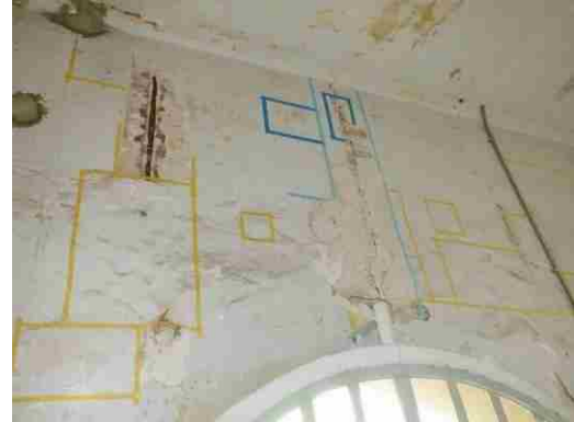
図 2-1-34 元守衛室東面 仕上げ材の浮き
