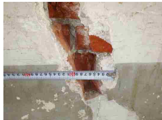
図 2-1-08 部屋西面のひび割れ ひび割れ部表面の煉瓦が欠けていて、モルタル・漆喰により欠損部補修がなされている
