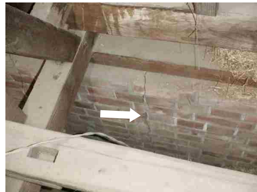
図 2-1-04 部屋西面のひび割れ（天井裏） 幅 2.0mm 程度のひび割れが見られる
