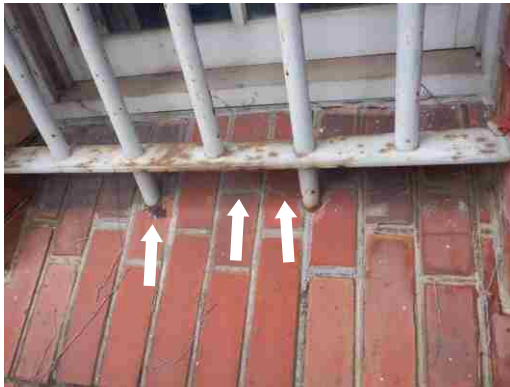
図 2-1-15 南面開口部 金物周りのひび割れ
