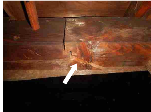
図 2-1-50 母屋のひび割れ 継手（追掛大栓）部分にひび割れがみられる
