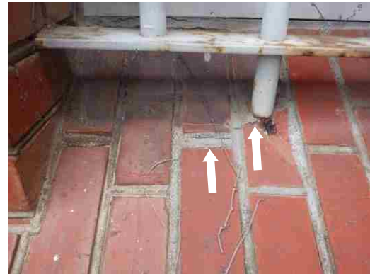
図 2-1-16 南面開口部 金物周りのひび割れ
