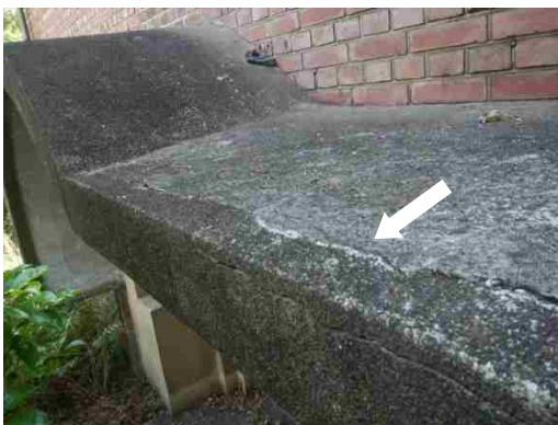
図 2-1-31 コンクリート庇のひび割れ・浮き 庇上面は全体的に浮きが生じている
