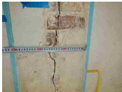
図 2-1-02 元守衛室東面のひび割れ 幅 2.0～5.0mm 程度のひび割れが見られる
