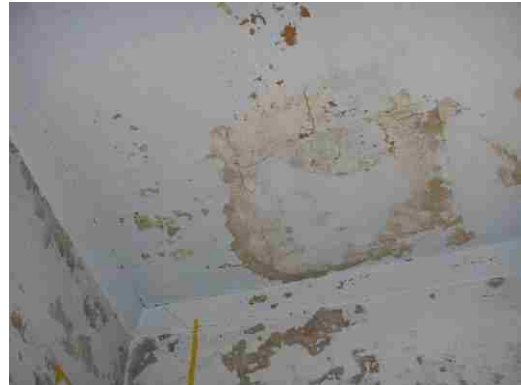
図 2-1-40 元守衛室天井 漆喰のひび割れ・塗装剥離
