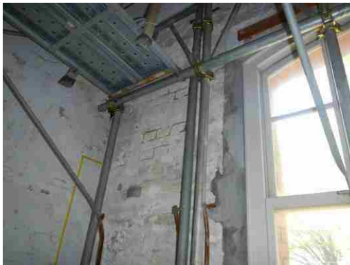
図 2-1-35 元守衛室北面 仕上げ材の剥離 仕上げ材が剥落し、煉瓦面が露出している
