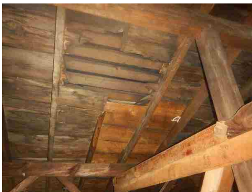
図 2-1-47 野地板の穴、野垂木の一部欠失 当初野地板と野垂木が一部欠失し、屋根下地が露出している
