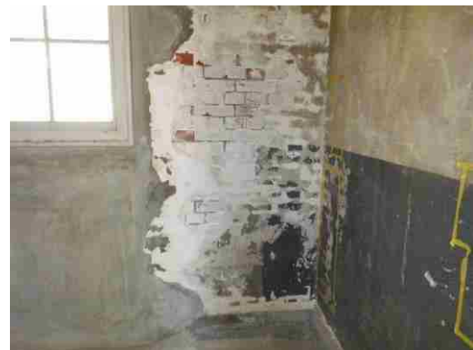
図 2-1-38 部屋北面 仕上げ材の剥離 仕上げ材が剥落し、煉瓦面が露出している
