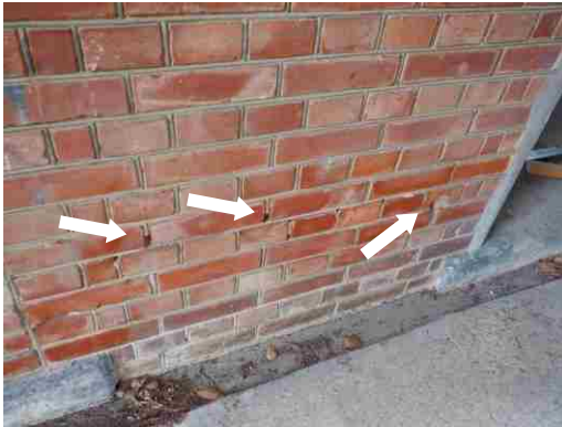
図 2-1-27 通路西面 覆輪目地の剥離
