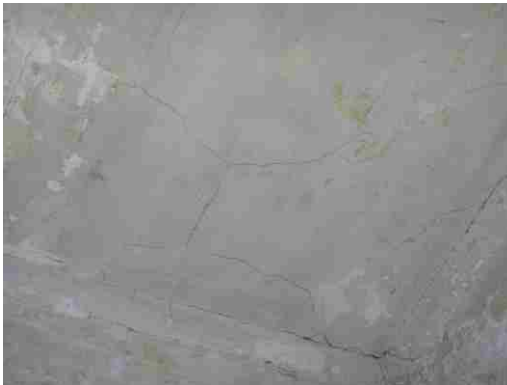
図 2-1-41 部屋天井 漆喰のひび割れ・塗装剥離
