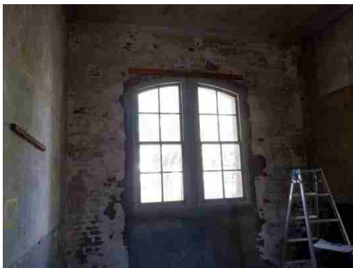
図 2-1-37 部屋北面 仕上げ材の剥離 仕上げ材が剥落し、煉瓦面が露出している
