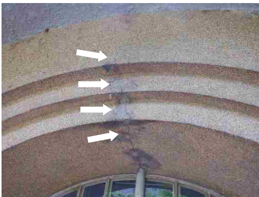
図 2-1-11 東面アーチ開口上部のひび割れ 外部もひび割れが発生している
