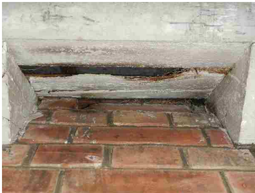
図 2-1-51 化粧軒裏の腐朽 東面の化粧軒裏に腐朽あり
