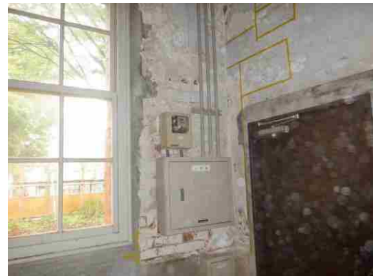
図 2-1-36 元守衛室北面 仕上げ材の剥離 仕上げ材が剥落し、煉瓦面が露出している
