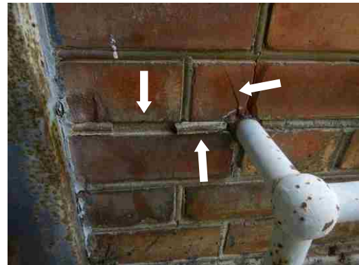
図 2-1-18 通路東面 金物周りのひび割れ と覆輪目地仕上げの剥離
