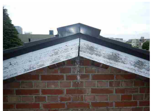
図 2-1-54 塗装の剥がれ 外部の木部にぬられている白ペンキ塗装は 全体的にはがれている
