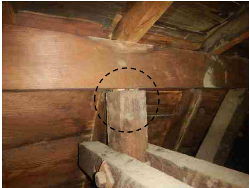
図 2-1-49 仕口のあき 母屋束と母屋の仕口に隙間あり
