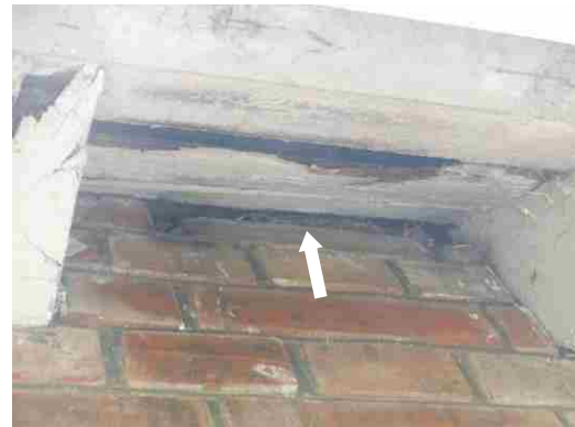
図 2-1-20 西面壁頂部の煉瓦積破損
