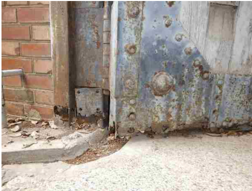
図 2-1-56 南面大扉鉄板の腐食、木部の腐食 建具及び建具枠の木部は腐朽により一部欠失し、鉄板も腐食が著しい
