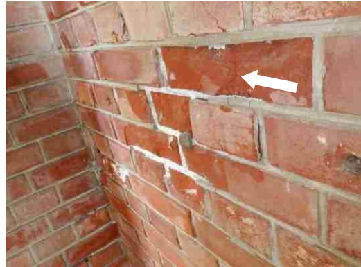
図 2-1-22 通路東面煉瓦の表層剥離
