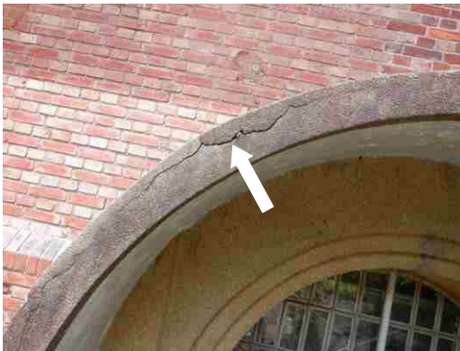
図 2-1-29 コンクリート庇のひび割れ
