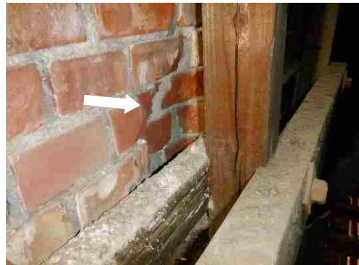
図 2-1-26 小屋裏北面 煉瓦の部分欠損
