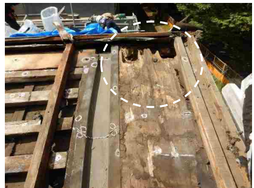
図 2-1-52 けらば側の厚板の腐朽 屋根の頂部に腐朽あり
