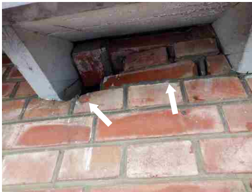
図 2-1-19 西面壁頂部の煉瓦積破損
