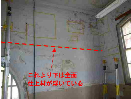
図 2-1-33 元守衛室東面 仕上げ材の浮き
