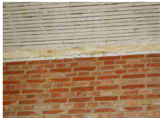
図 2-1-44 通路天井 仕上げ材の剥離・木摺りの露出
