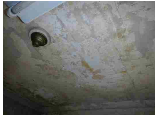
図 2-1-42 部屋天井 漆喰のひび割れ・塗装剥離
