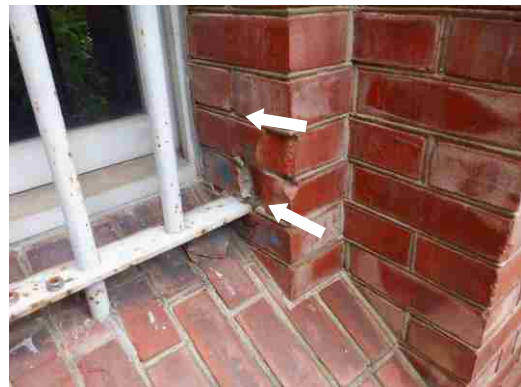
図 2-1-14 南面開口部 金物周りのひび割れ・破損
