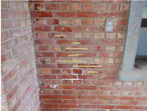
図 2-1-21 通路東面 煉瓦の表層剥離・浮き マスキングテープは煉瓦表層の浮きを示す
