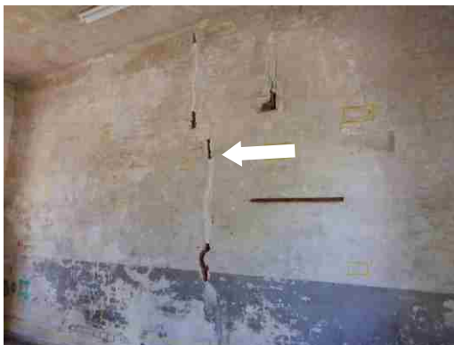
図 2-1-07 部屋西面のひび割れ 西面のほぼ中央にひび割れがみられる
