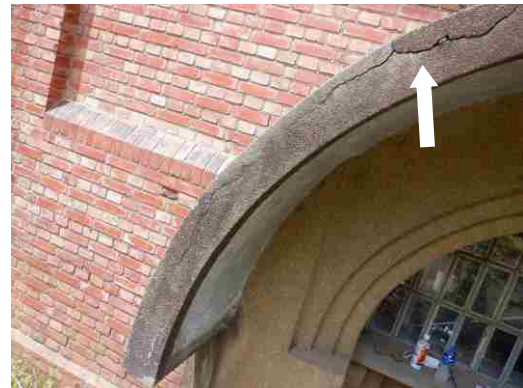
図 2-1-30 コンクリート庇のひび割れ
