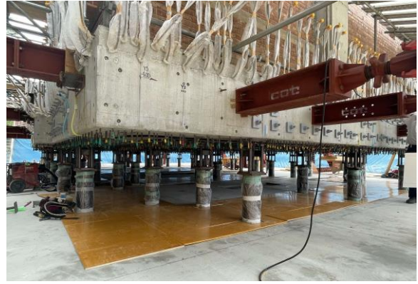
写真4 正門直下の状況
