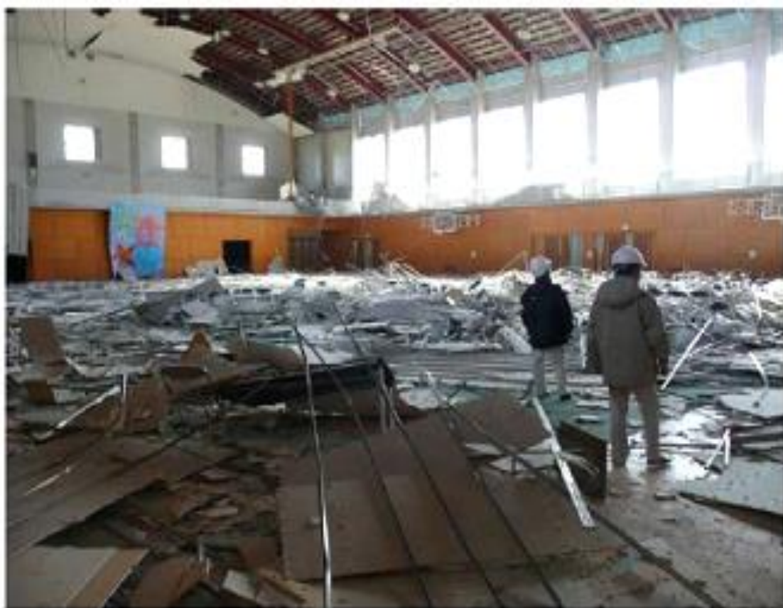
天井仕上げ材が散乱した 体育館内
