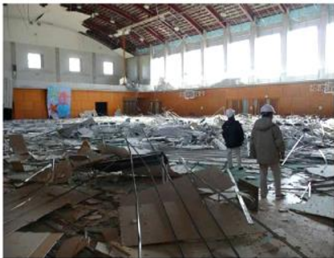
天井仕上げ材が散乱した 体育館内
